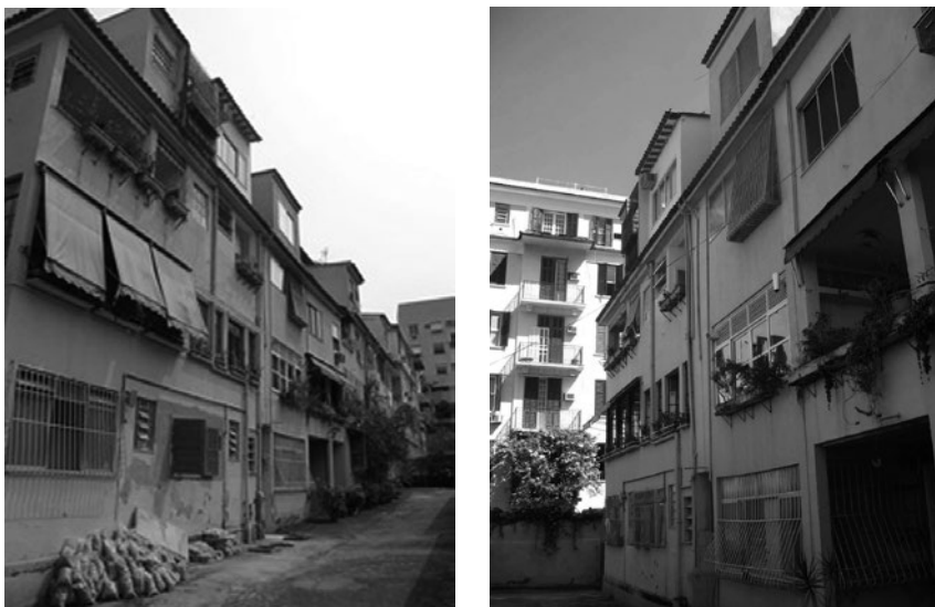
Fig. 14. Descaracterização das fachadas dos fundos de edifício da Praça Múcio Leitão.
