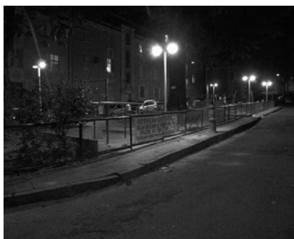
Fig. 17. Luminárias instaladas na Praça.
